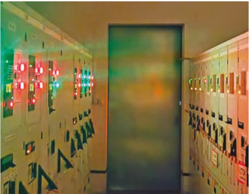
Распределительное устройство 10 кВ
