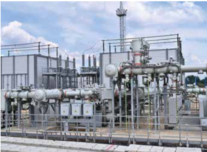
Рис. 2. КРУЭ открытой установки на ПС Сербиновская
