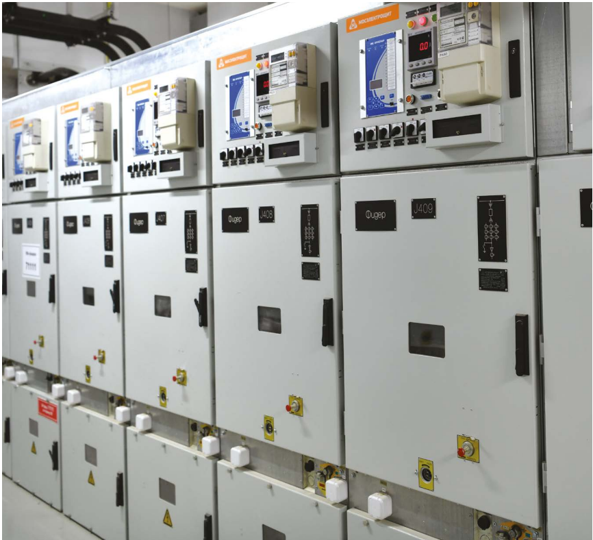
Шкаф КРУ 20 кВ
