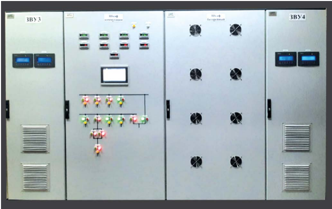
Рис. 3. Внешний вид СОПТ на ПС 220 кВ Сварочная
