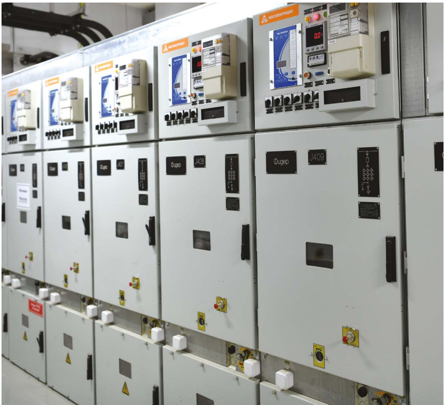
Шкаф КРУ 20 кВ
