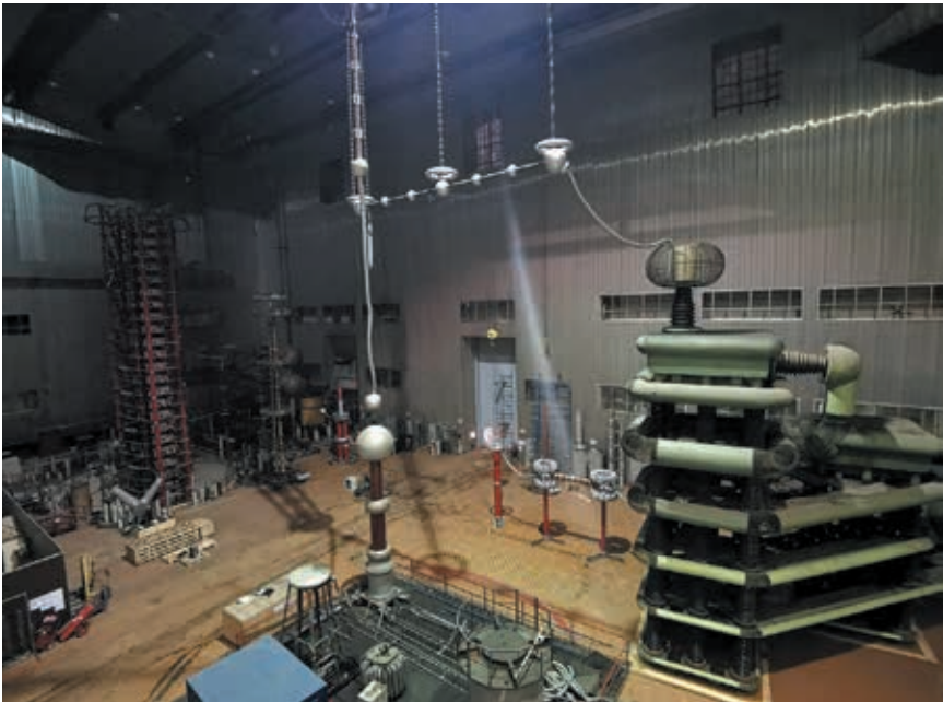
Большой высоковольтный зал ИЦ ВЭИ
