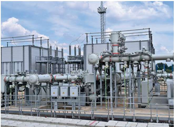
Рис. 2. КРУЭ открытой установки на ПС Сербиновская
