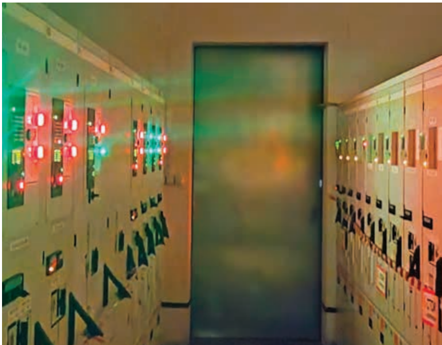
Распределительное устройство 10 кВ
