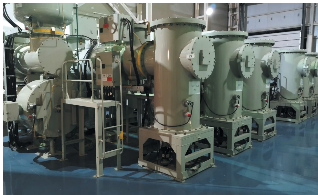
КРУЭ 110 кВ на подстанции 220 кВ «Поселковая»
