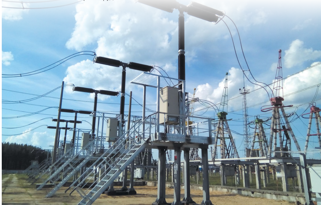
Замена воздушных выключателей на элегазовые как пример технического перевооружения электросетевых объектов
