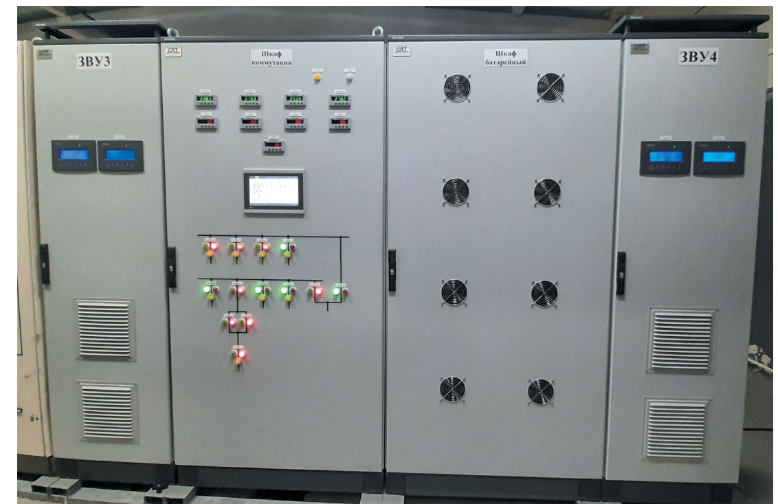
Рис. 1. Внешний вид СОРП. Слева направо: зарядно-выпрямительное устройство, шкаф коммутации, литий-ионная аккумуляторная батарея, зарядно-выпрямительное устройство
