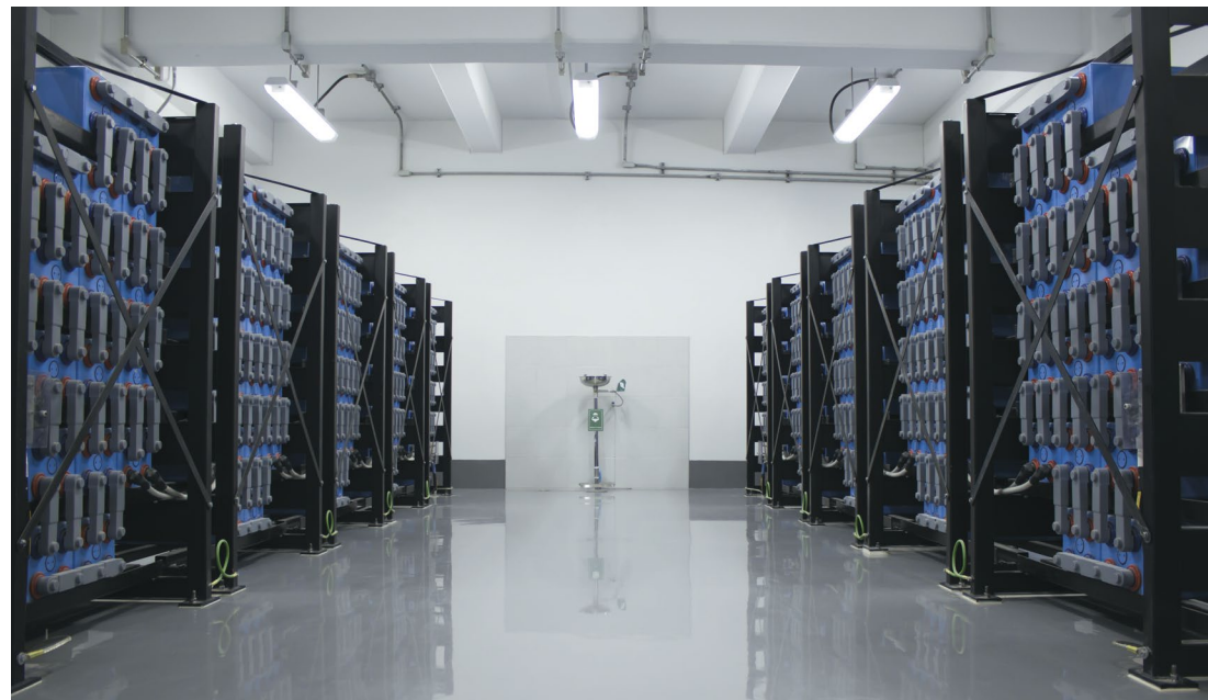
Современные системы накопителей электроэнергии, основанные на аккумуляторных батареях, обеспечивают надежную, бесперебойную работу подстанций
