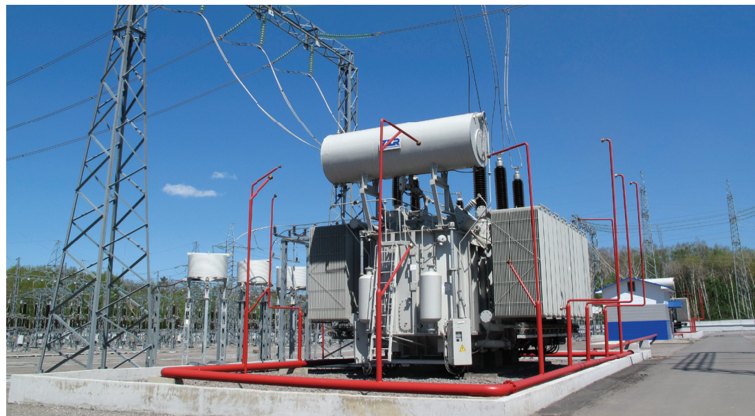
Контроль состояния трансформаторов позволяет обеспечивать надежную работу электросетевых объектов
