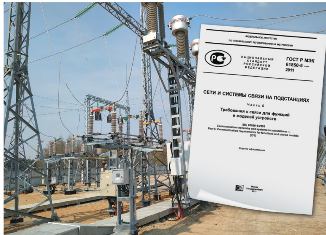
Стандарт МЭК 61850 — основной документ, определяющий правила взаимодействия между собой различного оборудования, расположенного на подстанции
