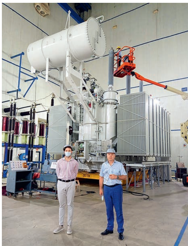
▼ Представители ГК «Изолятор» в испытательном зале завода Prime Meiden Limited, на заднем плане — трансформатор с вводами «Изолятор» на напряжение 252 кВ
