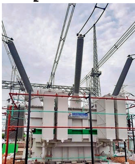
Первый в мире шунтирующий реактор на напряжение 420 кВ с жидким эфирным диэлектриком
