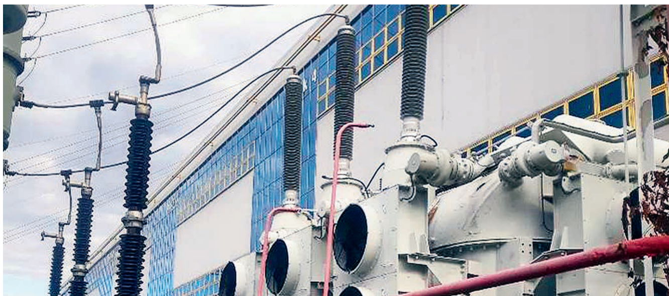
Трансформатор мощностью 240 МВА с вводами «Изолятор» на напряжение 252 кВ на электростанции Dolna Odra в Польше
