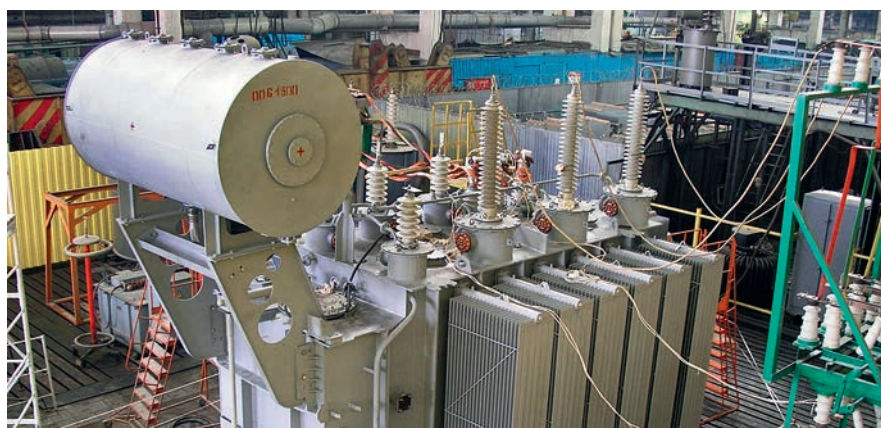
Силовой трансформатор номинальной мощностью 40 МВА класса напряжения 110 кВ в испытательном центре завода «Тольяттинский Трансформатор» (фото: «Тольяттинский Трансформатор»)
