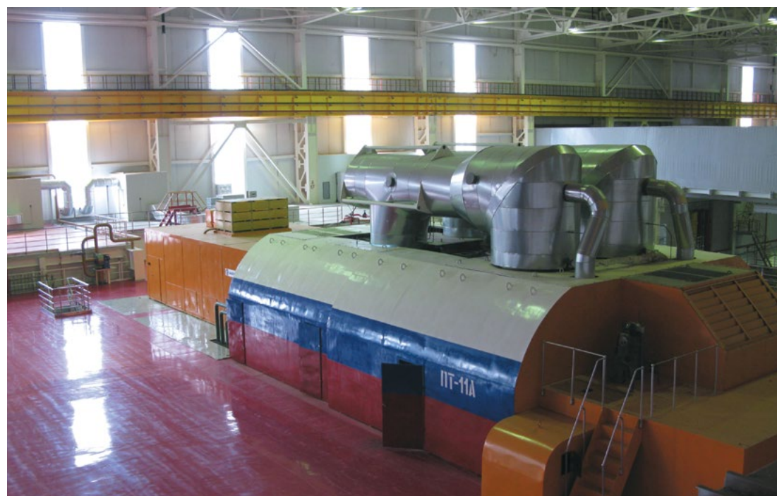
Асинхронизированный турбогенератор ТЗФАУ-160-2У3 мощностью 160 МВт на блоке № 11 ТЭЦ-21 «Мосэнерго»
