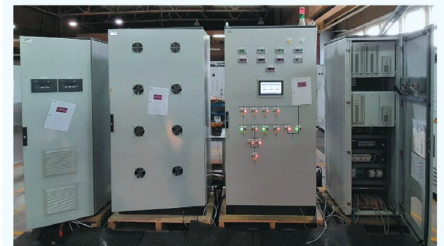
Обозначения: 1, 4 — зарядно-выпрямительное устройство (ЗВУ); 2 — шкаф коммутации; 3 — литий-ионные аккумуляторные батареи (ЛИАБ).
