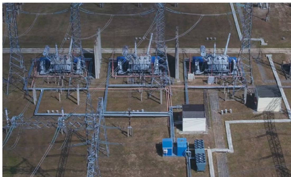
Рис. 5 Вид смонтированного оборудования на ПС 750 кВ «Владимирская»
