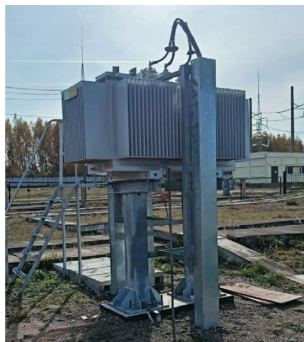
Рис. 12 ТСН-3 ПС 500 кВ «Нижегородская», тип ТМГАМ-1000/10
