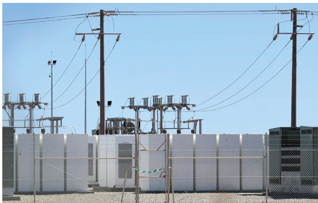
Батарея современных накопителей электроэнергии
