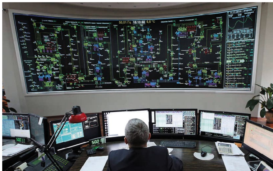
Диспетчерский центр управления электрической сетью
