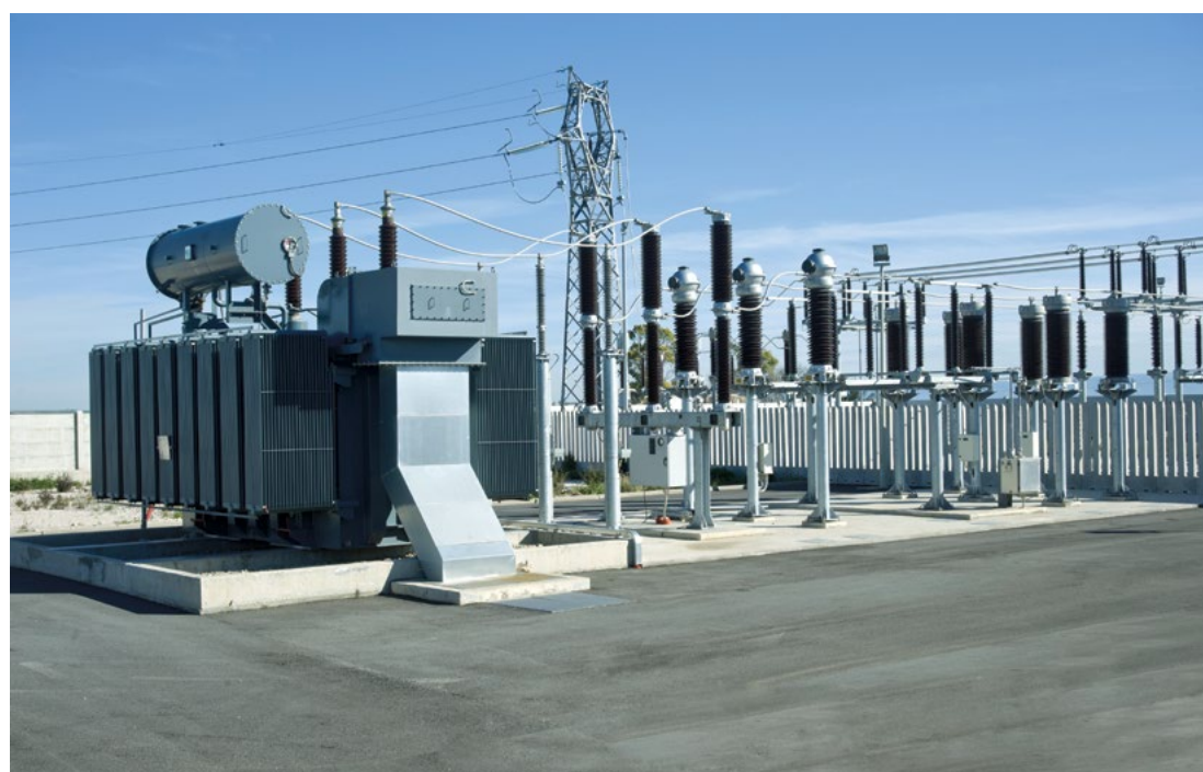
Силовой трансформатор на современной высоковольтной подстанции
