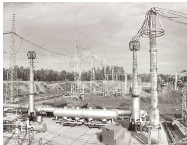
Рис. 3. КРУЭ на напряжение 1150 кВ (ячейка КРУЭ 1150 кВ)
