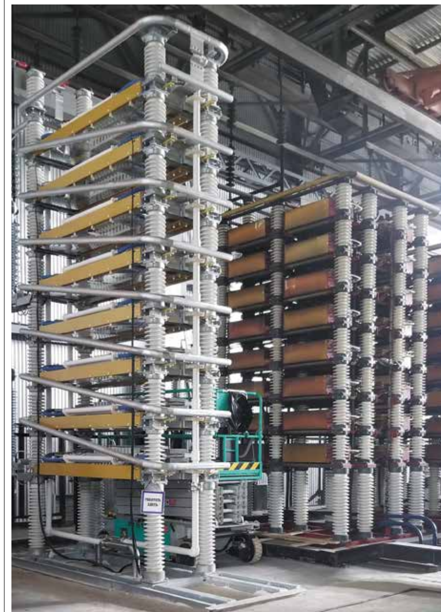
Рис. 6. БВПМ-М в вентиляльном зале КВПУ-3
