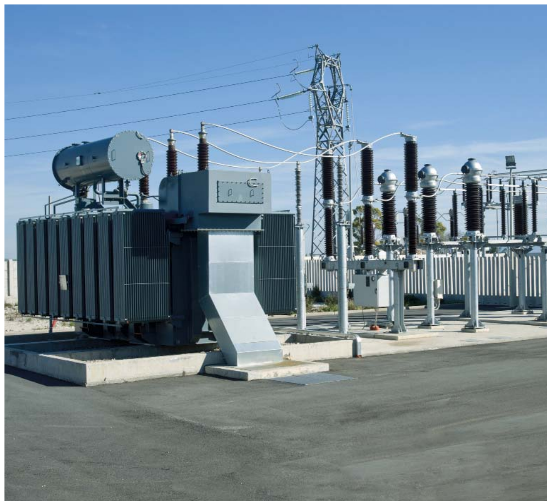
Силовой трансформатор на современной высоковольтной подстанции
