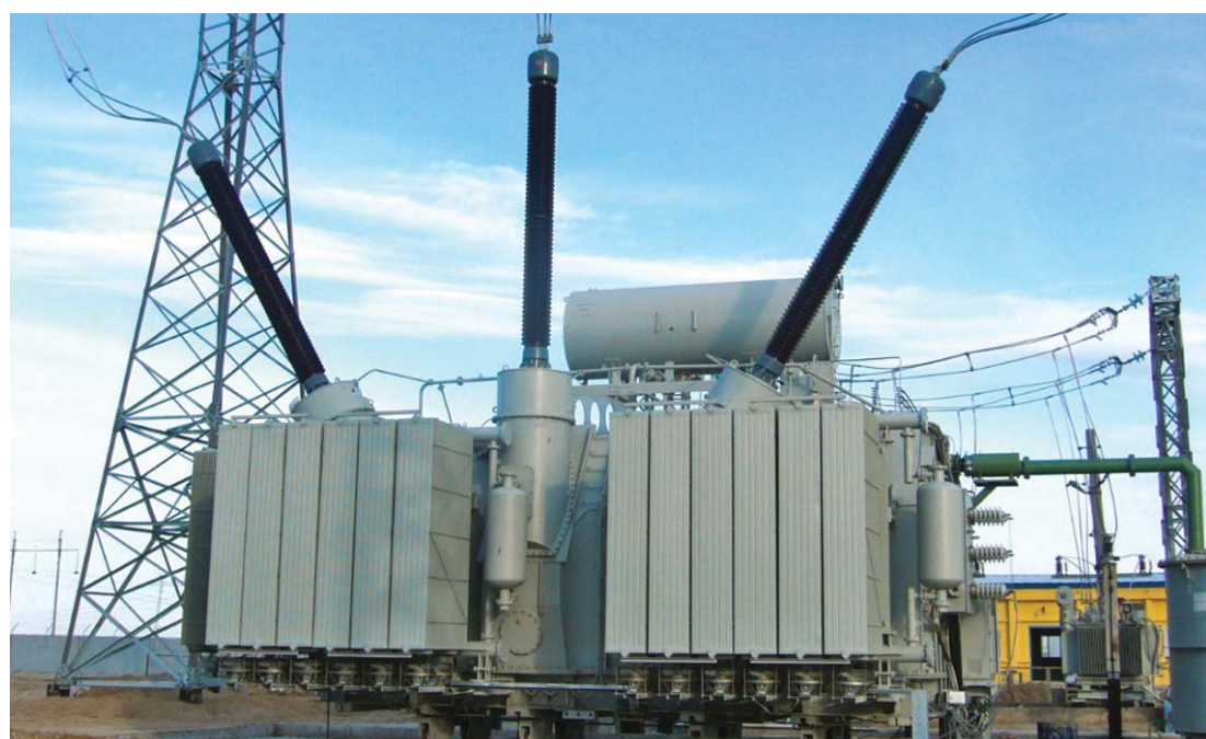
УШР типа РТУ-180000/500 трехфазного исполнения на ПС «Агадырь», Казахстан
