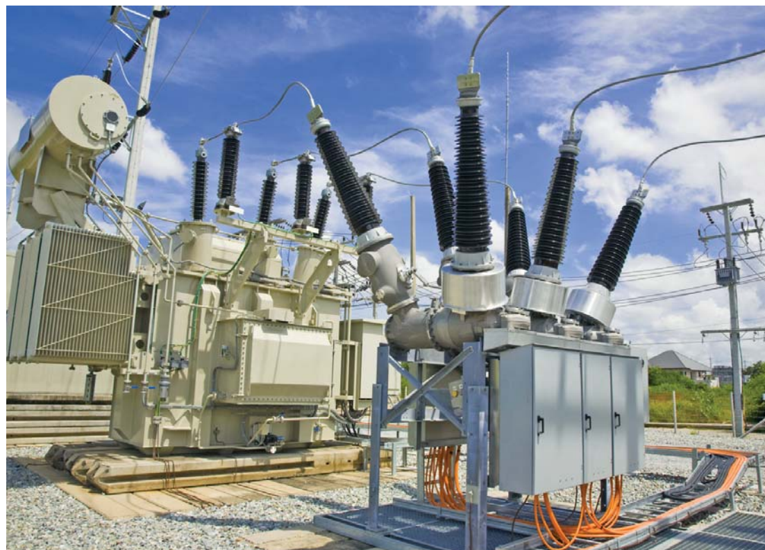
Высоковольтные выключатели на подстанции
