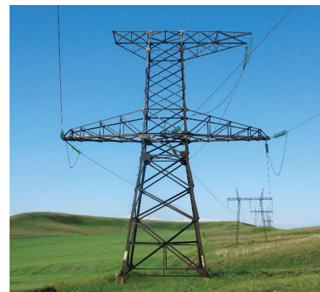
Рис. 1 Анкерная опора ВЛ 220 кВ «Алматы — Главная»
