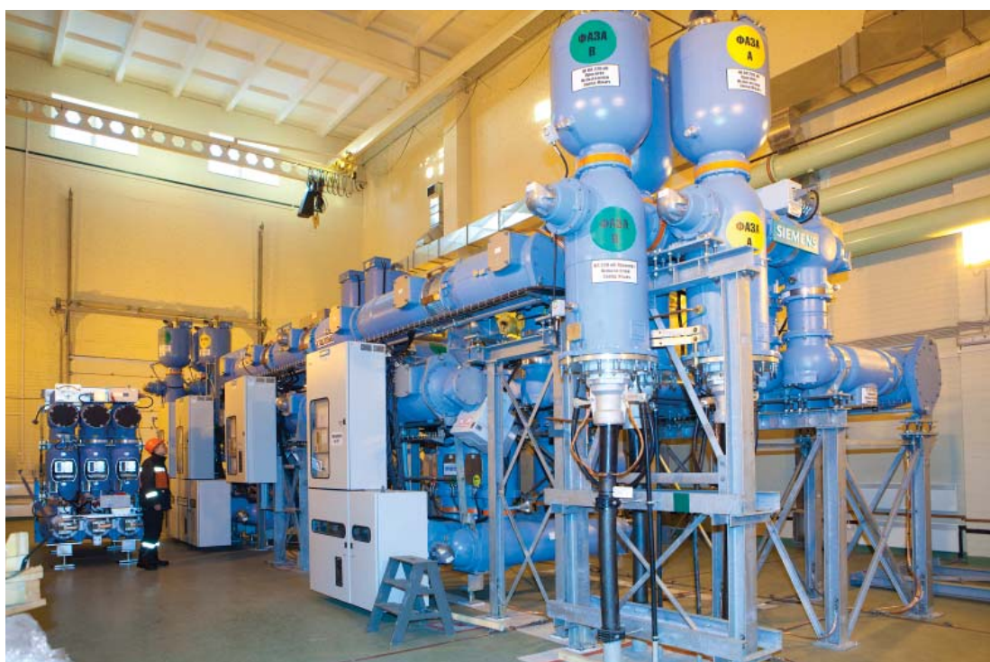
Рис. 2 ПС 330 кВ «Завод Ильич»
