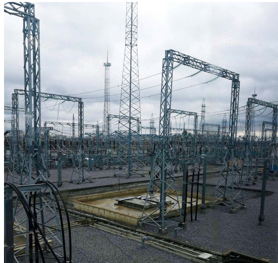
Рис. 1 Подстанция 330 кВ «Губкин» в Белгородской области
