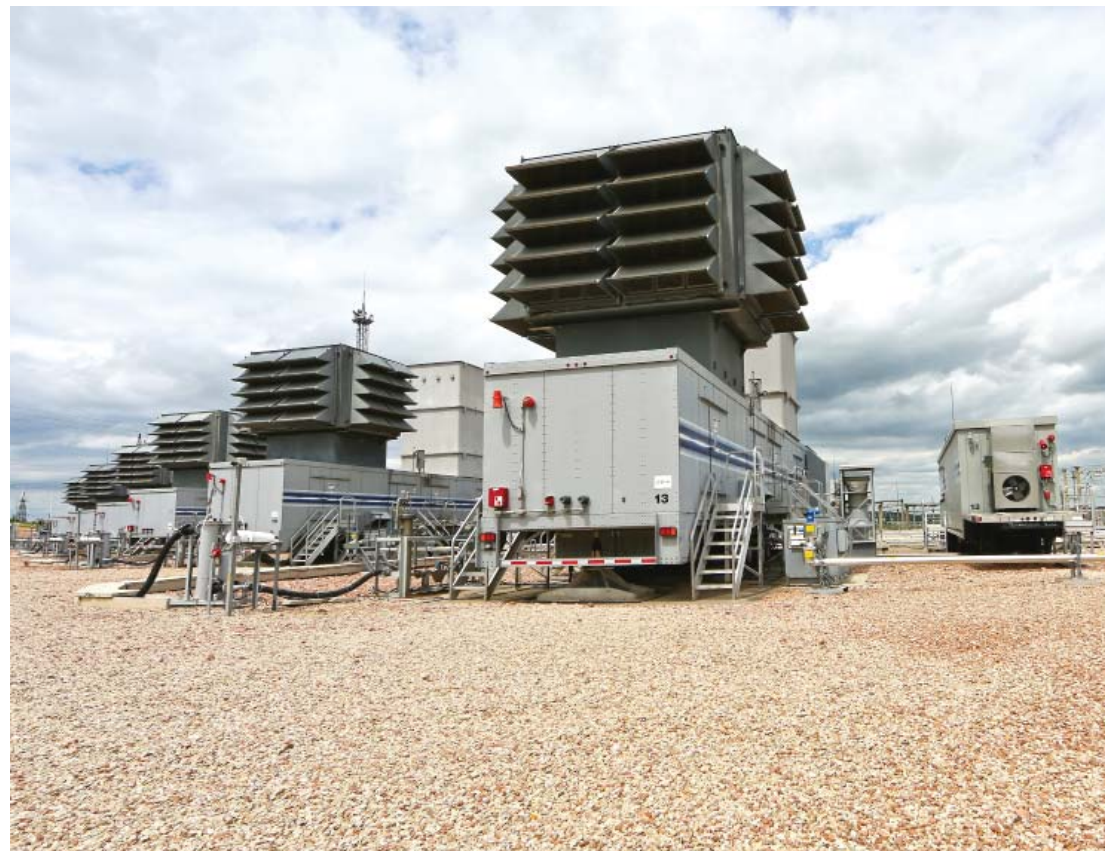
Площадка «Симферопольская МГТЭС»
