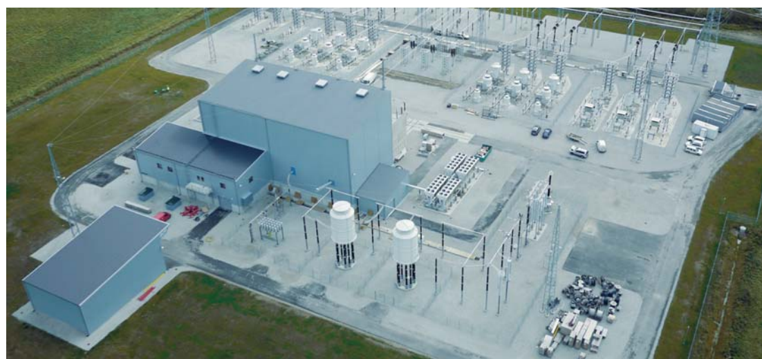
Преобразовательная подстанция передачи постоянного тока Estlink 2 (Эстония — Финляндия). Мощность 650 МВт
