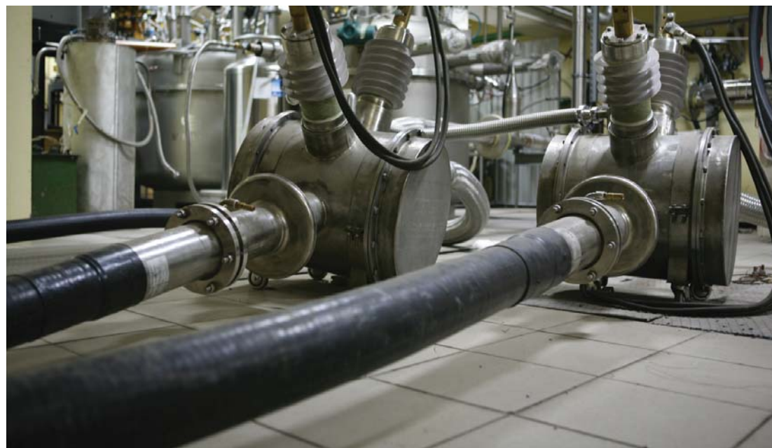
Общий вид криогенной станции с токовыми вводами кабельной линии (на переднем плане)
