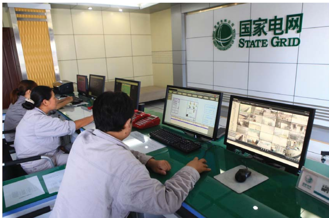
Современный диспетчерский пульт управления электроэнергетической системой. Диспетчерский центр контроля Китайской государственной электрической сети в г. Джиуджунанг
