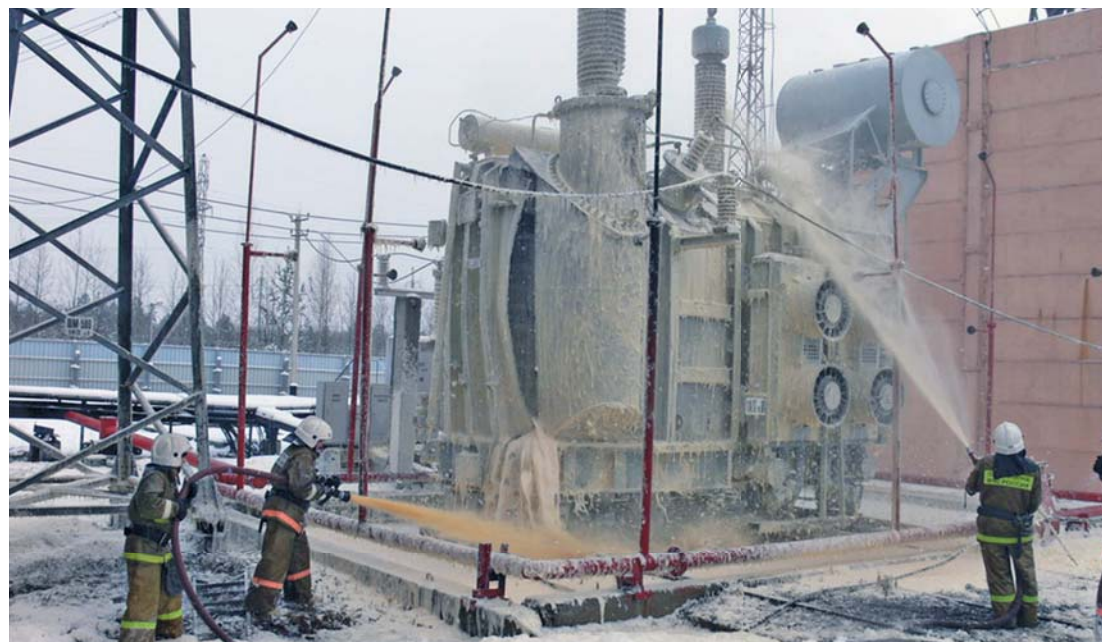
Трансформатор на подстанции в Западной Сибири после взрыва
