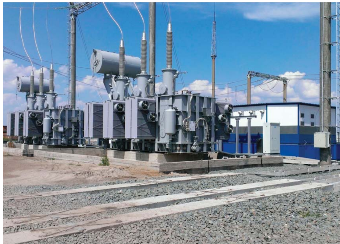
Внешний вид УШРТ на ПС 220 кВ «Светлая»
