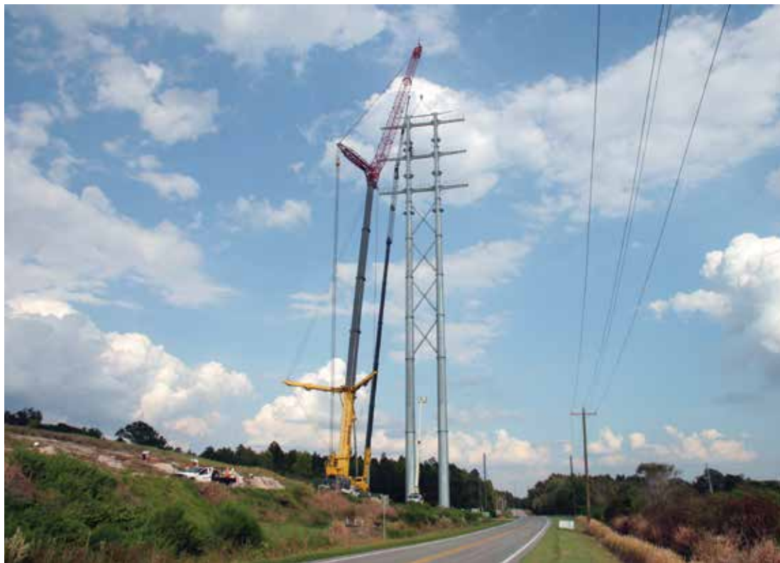
Высотная опора 220 кВ высотой 96 м в США
