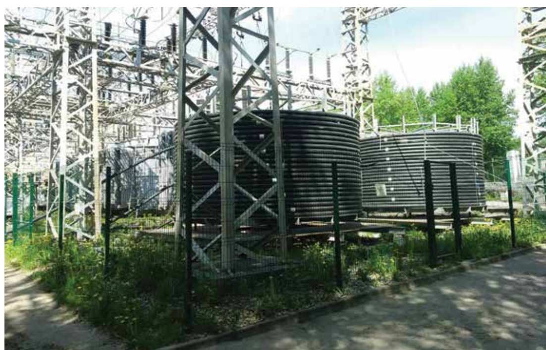
Два отрезка сверхпроводящего кабеля постоянного тока по 430 м каждый во время испытаний на полигоне АО «НТЦ ФСК ЕЭС»
