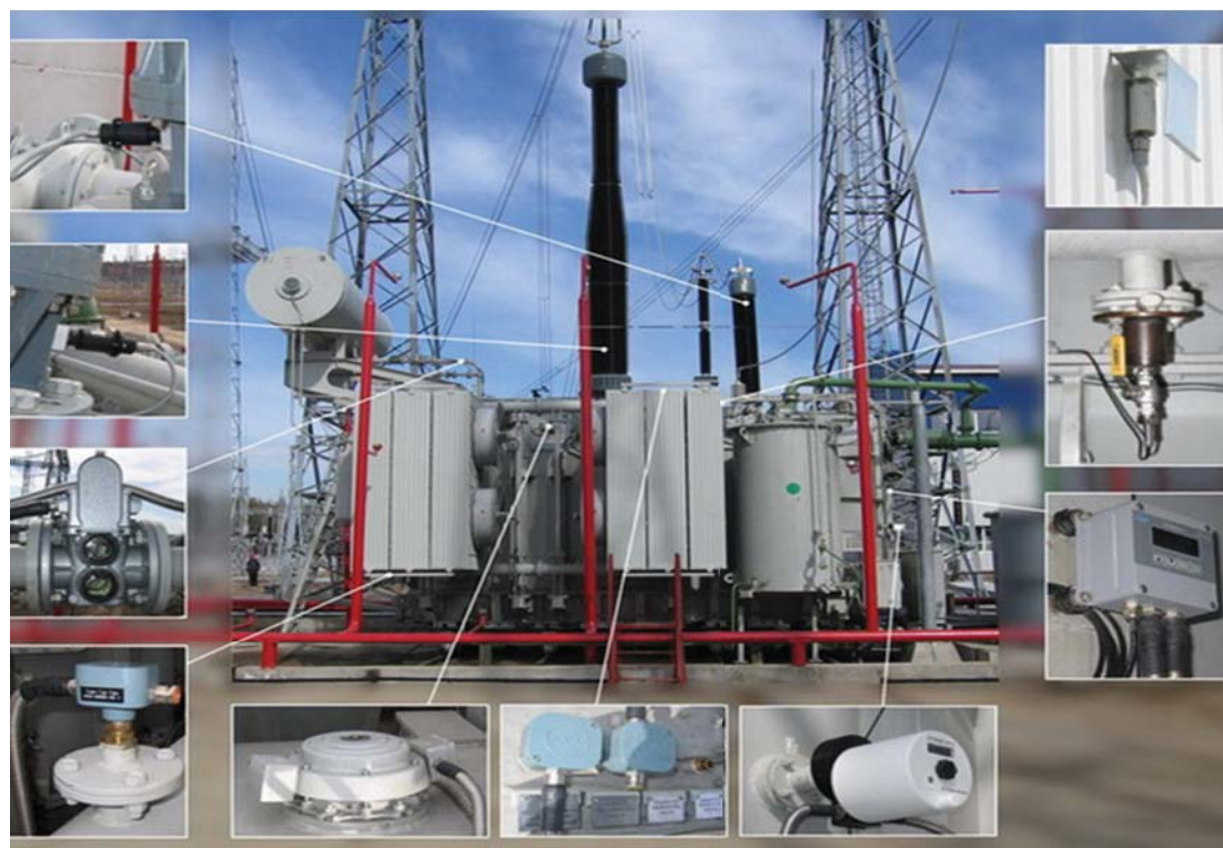
Рис. 1 Первичные датчики в составе первых систем мониторинга, устанавливаемых на силовом оборудовании
