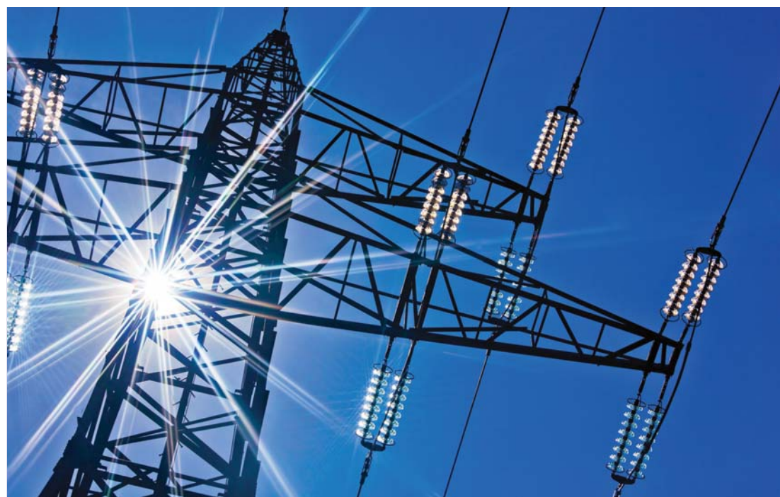
Потери мощности на корону в воздушных линиях существенно зависят от погодных условий
