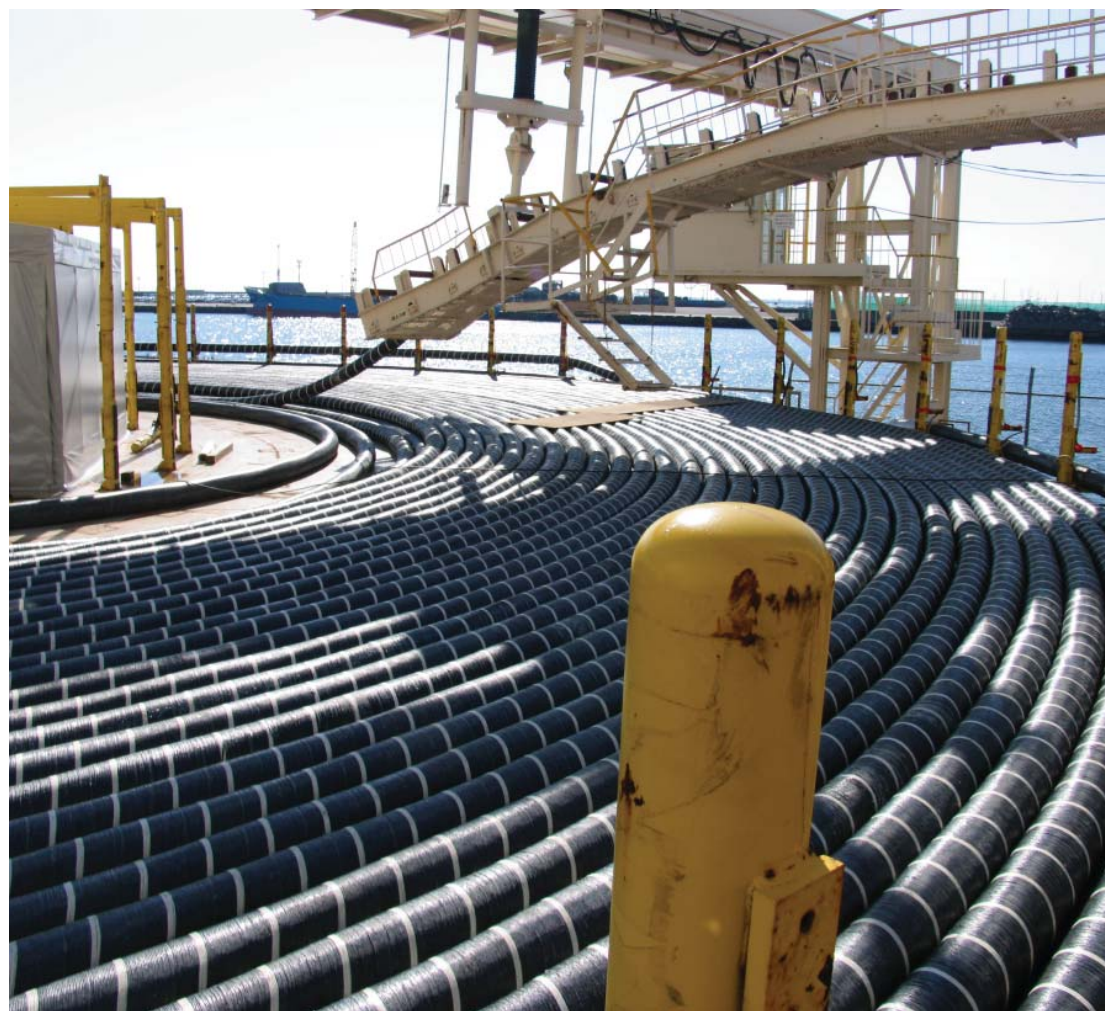
Кабель 220 кВ через пролив Босфор Восточный
