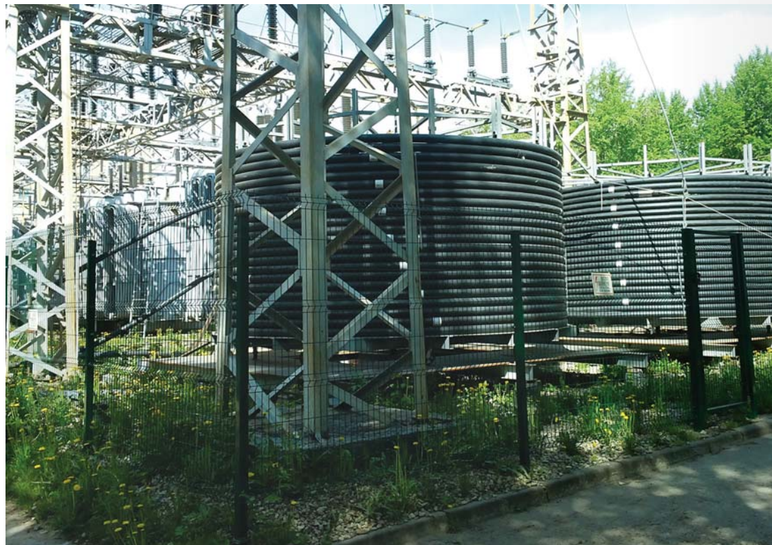
Рис. 3 Общий вид 860-метровой ВТСП КЛ на полигоне
