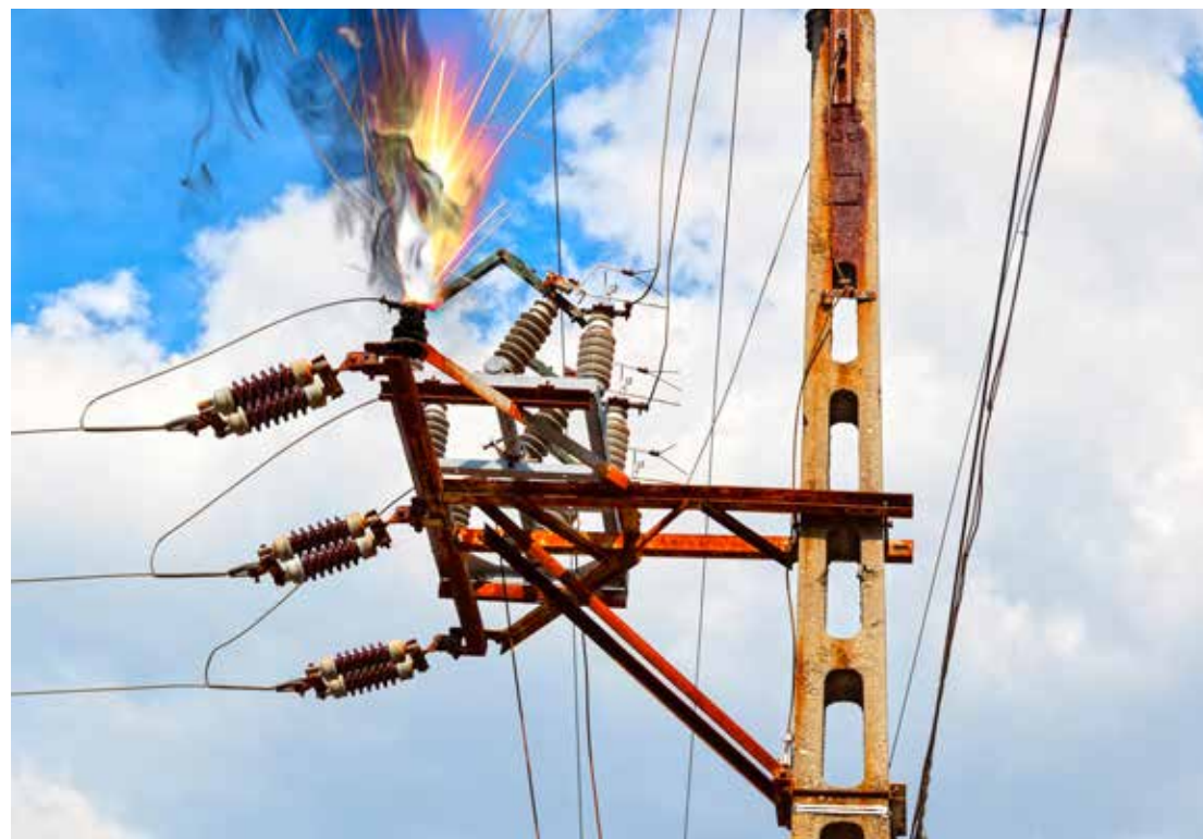
Дефекты изоляторов являются причиной серьезных аварий
