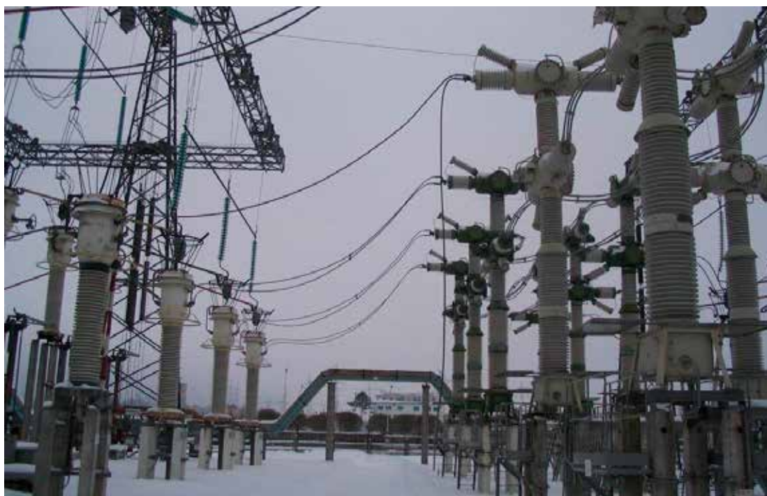
Пример КЗ в «мертвой зоне» распределительного устройства 330 кВ энергообъекта
