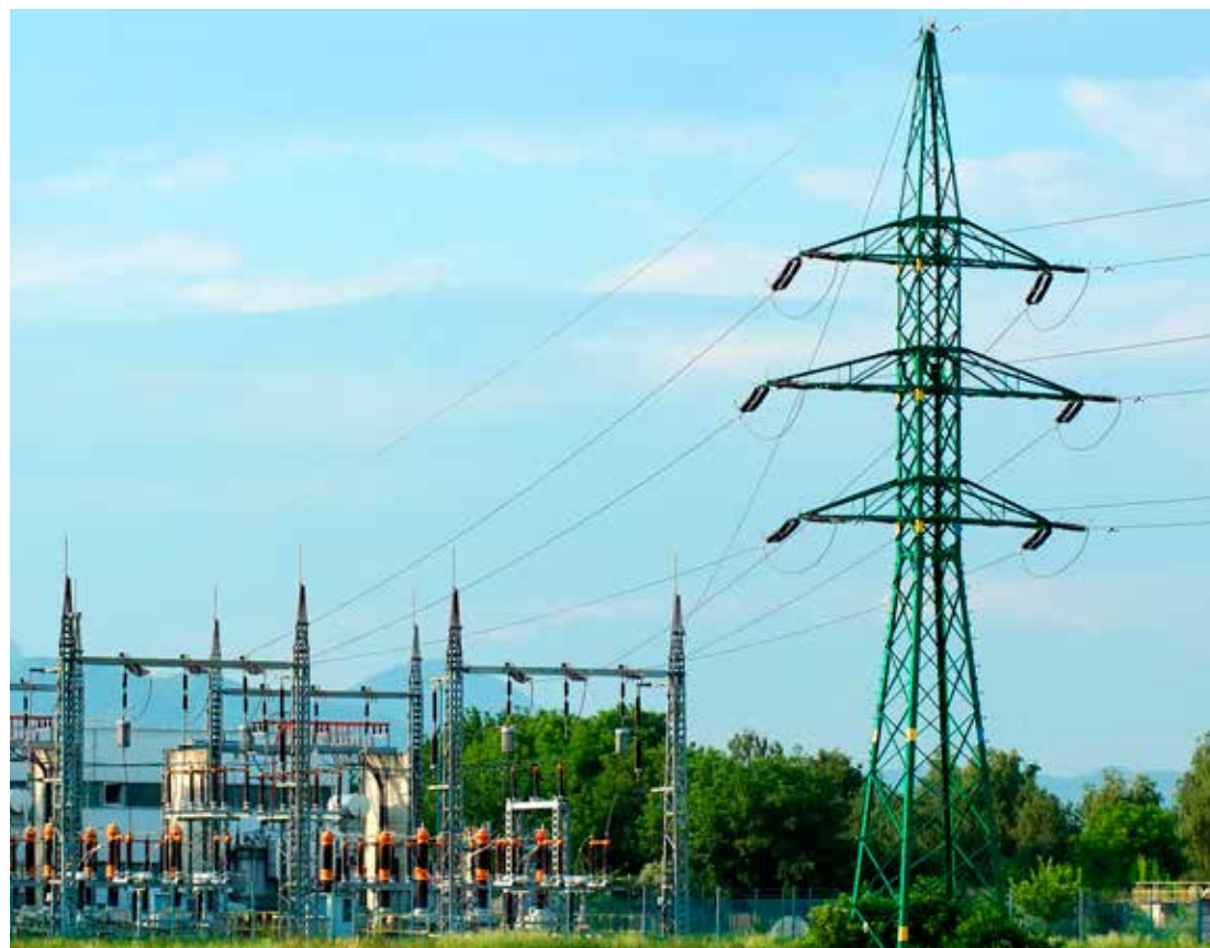
Надежность работы оборудования на современных подстанциях зависит от электромагнитной обстановки подстанции
