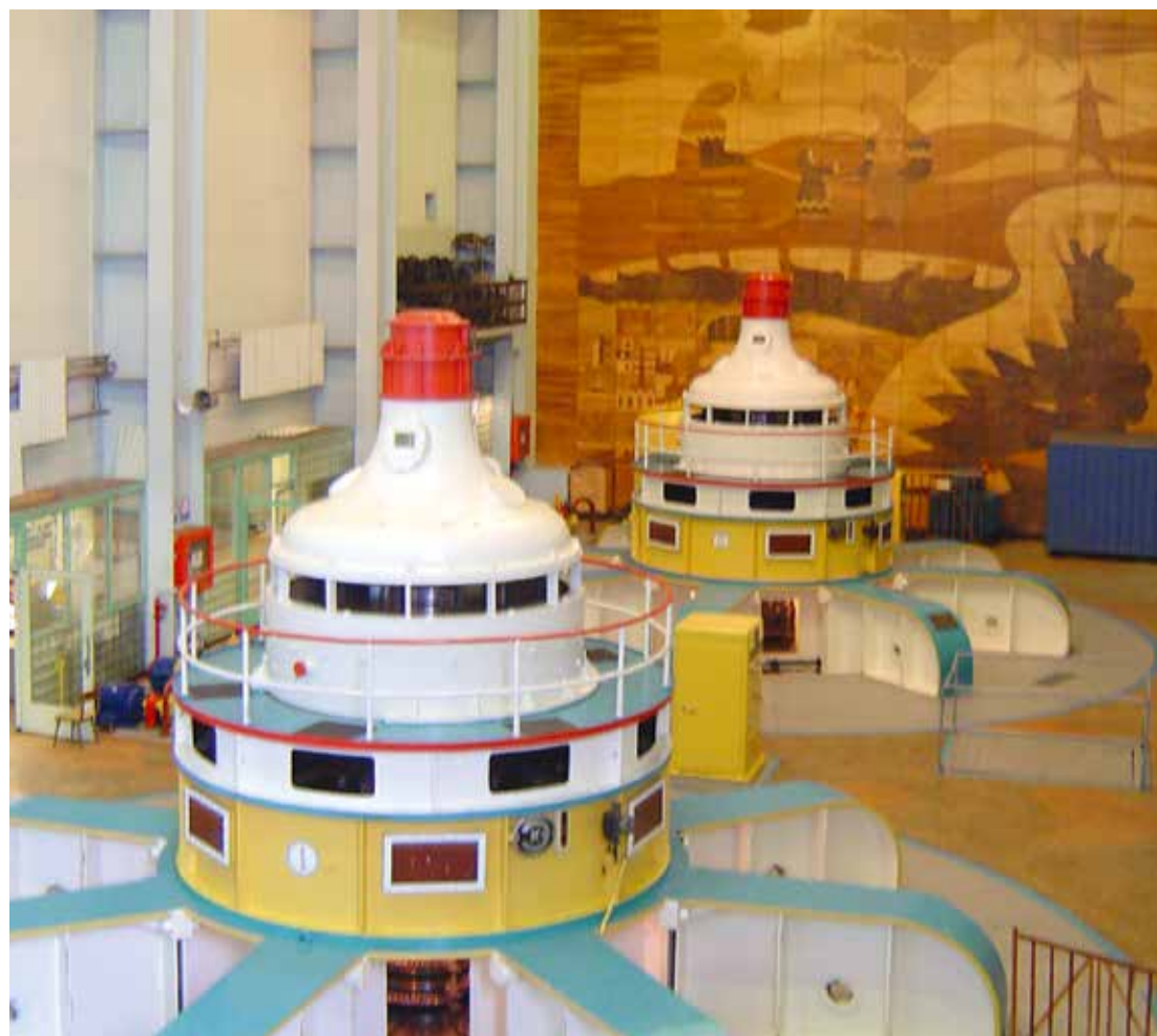
Машинный зал Иовской ГЭС (Мурманская область)
