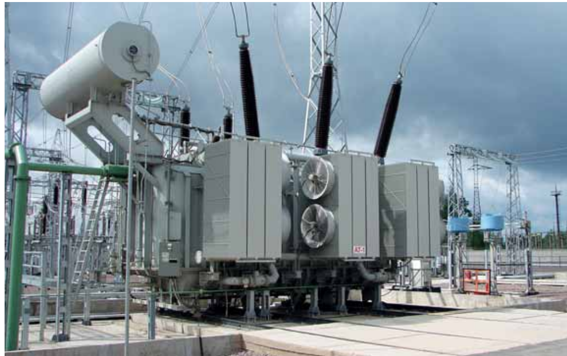
Рис. 3. Силовой трансформатор на ПС 330 кВ «Новгородская»
