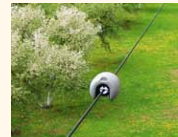
а) устройство OTLM (Overhead Transmission Line Monitoring) для измерения температуры провода и координат
