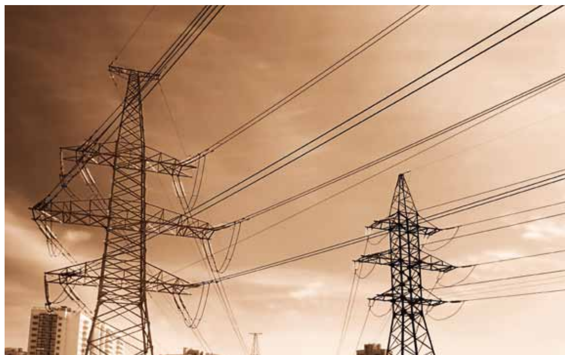
Общая протяженность воздушных и кабельных линий электропередачи напряжением 0,38–110 (220) кВ составляет 2 033 132 км. Источник: Положение о единой технической политике ОАО «Холдинг МРСК» в распределительном сетевом комплексе
