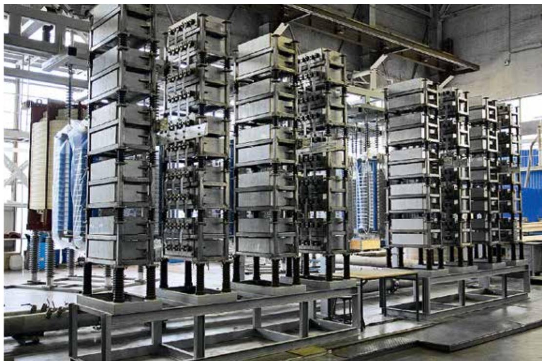
Рис. 3. Внешний вид преобразовательных устройств на испытаниях в ОАО «НТЦ ФСК ЕЭС»
