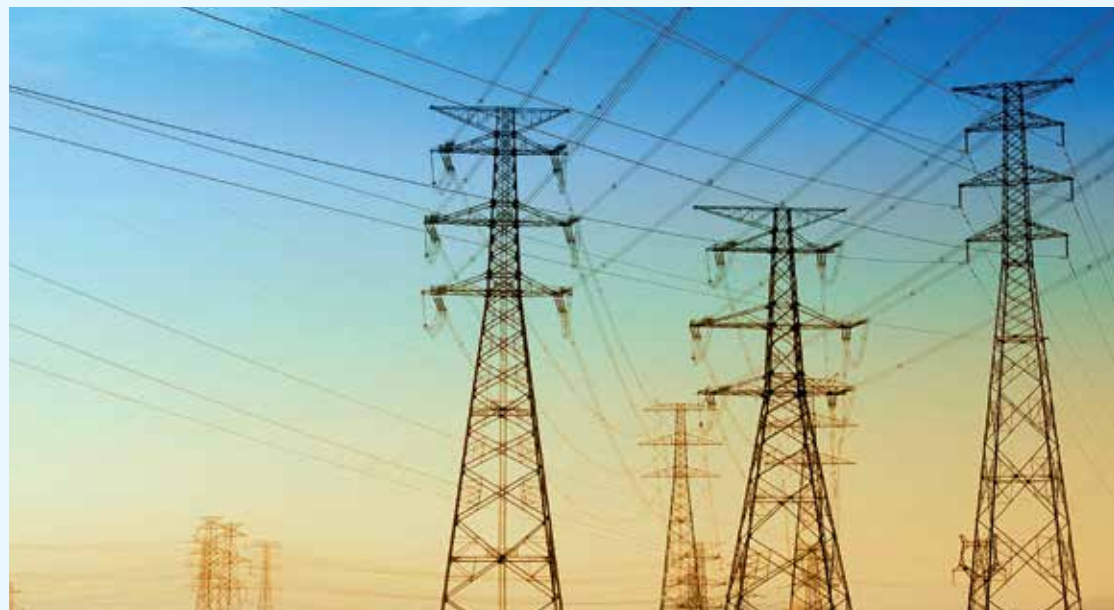
Воздушные линии электропередачи являются основным средством передачи и распределения электрической энергии
