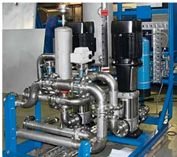
Рис. 2 (б). Насосная установка для охлаждения тиристорных вентилей
