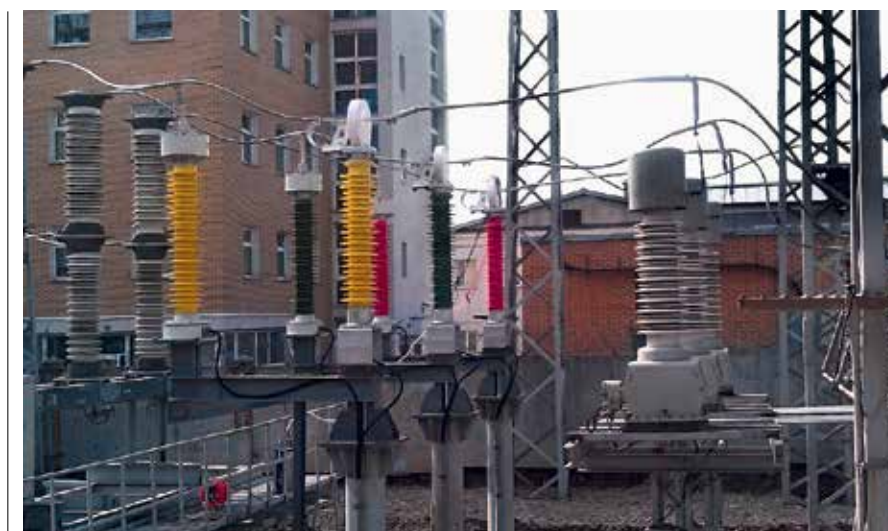
Рис. 1. Опытный полигон «Цифровая подстанция» в ОАО «НТЦ ФСК ЕЭС»
