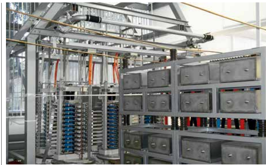
Рис. 3. Силовая часть и конденсаторные батареи СТАТКОМ
