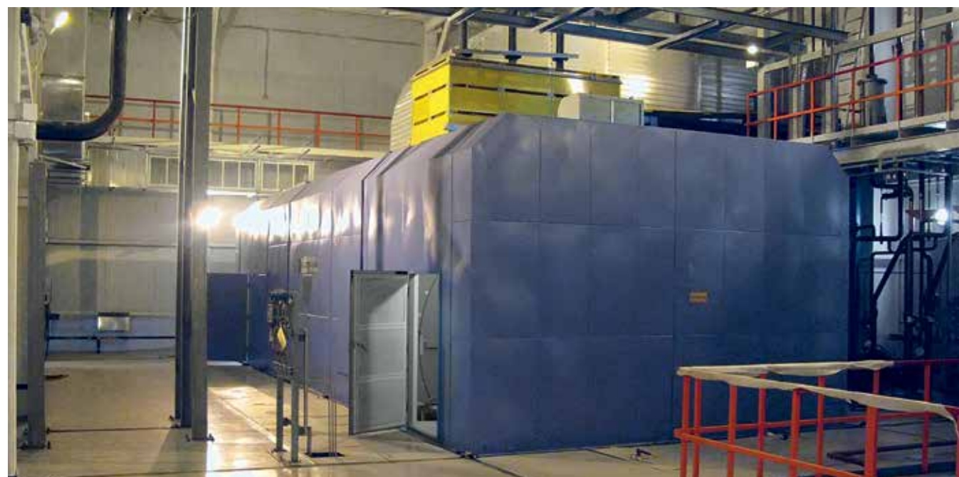
Рис. 4. Асинхронизированный компенсатор (АСК) мощностью 100 МВА на ПС 500 кВ «Бескудниково»
