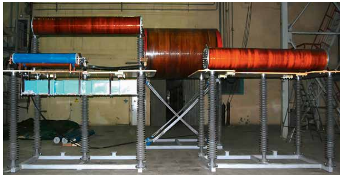
Рис. 9. Фотография стенда при поэлементных испытаниях ТОУ-220 в ТРИНИТИ
