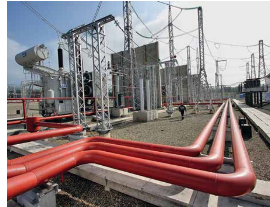
Анализ повреждаемости основного электрооборудования подстанций является необходимым этапом в оценке технического состояния электрооборудования
